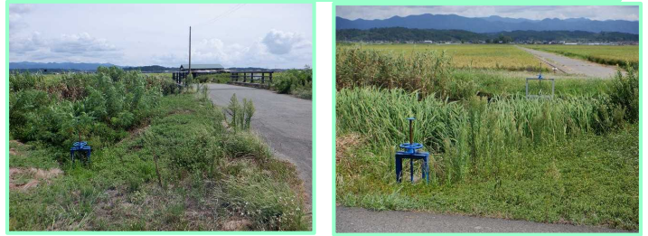
東部干拓第 1 工区承水路取水ゲート
