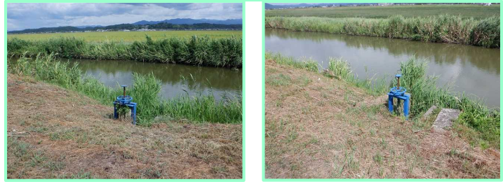
東部干拓第 2 工区承水路取水ゲート
