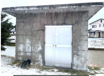
川向第2揚水機場
