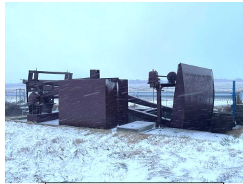
大堤大排水取水ゲート ウオッチマン
