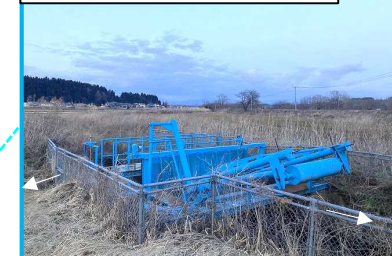
滝沢揚水機場
