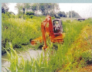
排水路内雑草繁茂による掘削
