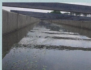
用水路内に繁茂した水草の状況
