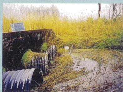
排水路のゴミの堆積状況
