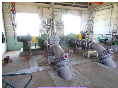
真坂揚水ポンプ
