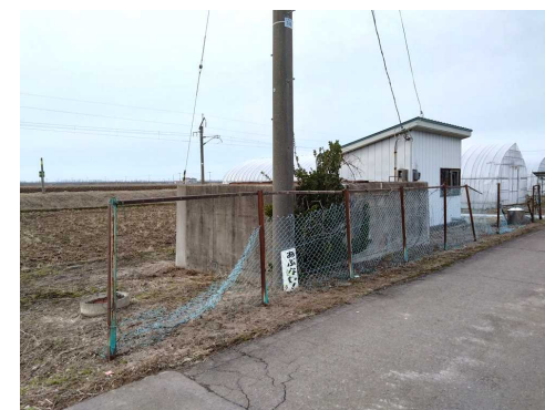
鉄道上揚水機
