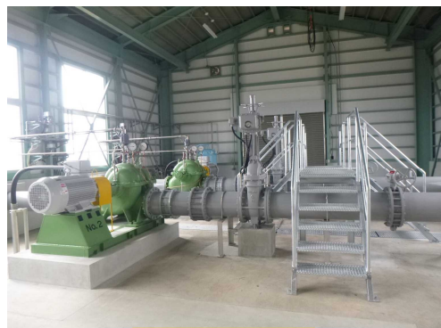
川口揚水ポンプ
