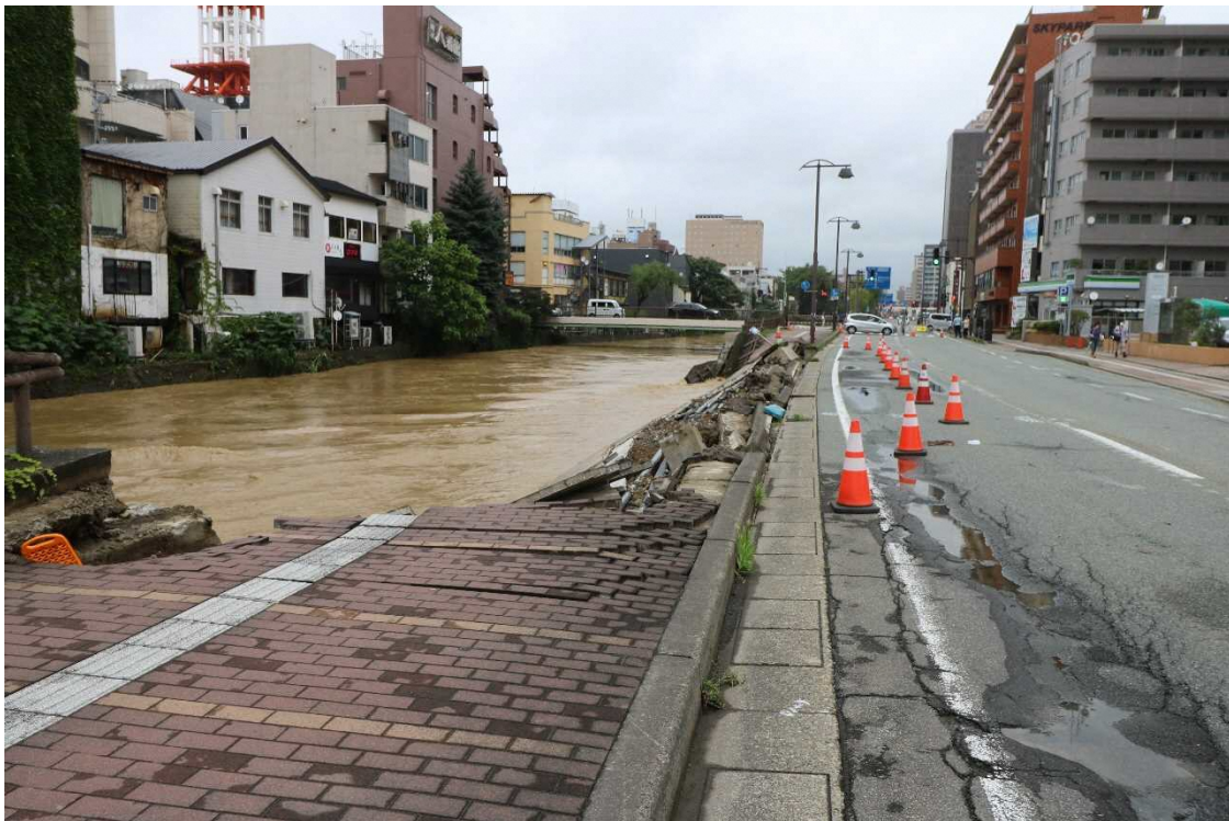
図 5：2023年7月大雨被害状況（旭川 河川浸食による護岸崩壊の様子） 20
