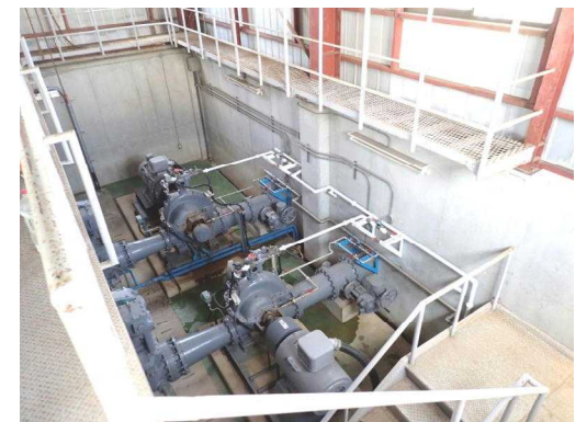
〔泉八日揚水機場（三種町）〕
