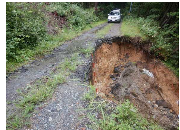
〔林道路体崩壊（大館市長坂線）〕
