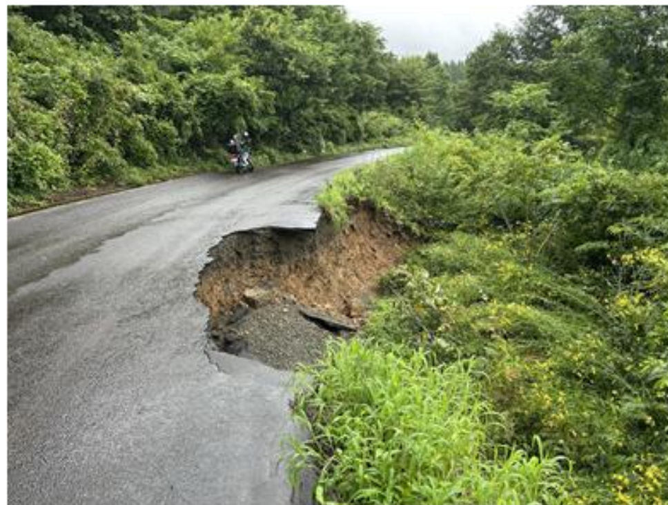
林道路体決壊（横手市 萱峠線）
