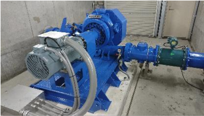
新型水車発電機 実証機
