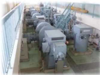
工業用水道 送水ポンプ
