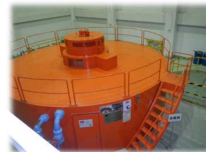
発電機(玉川発電所)
