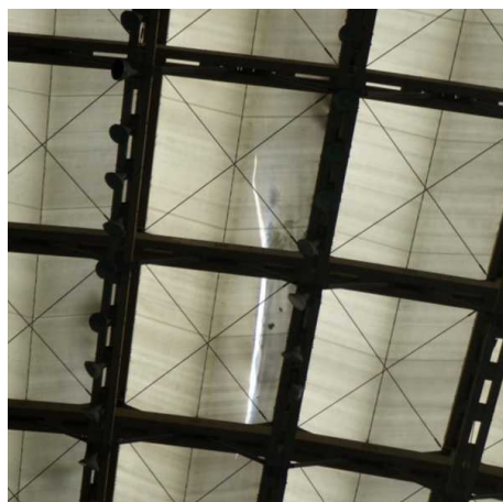
裂傷部分（内側）
