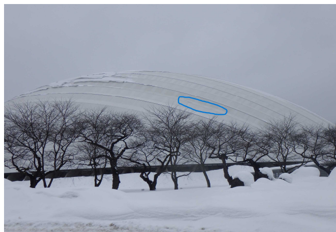
膜屋根裂傷部分（約12m）
