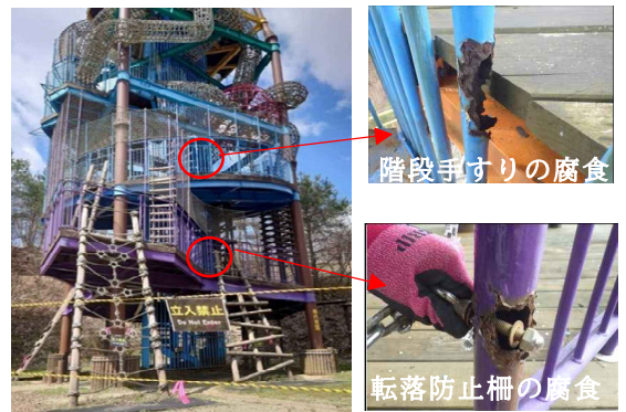
腐食により使用禁止措置中の遊具 (県立中央公園)
