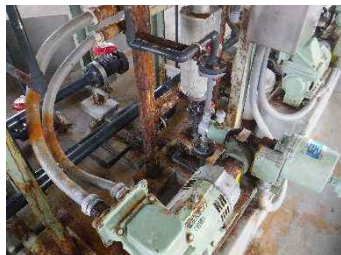
老朽施設の更新 塩素注入設備
