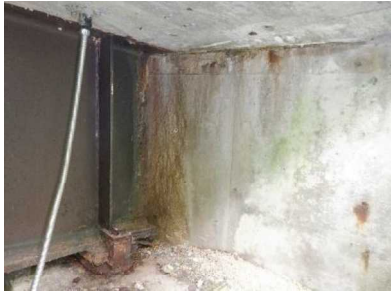
国道 103 号 生出5号橋 橋面からの漏水による支承発錆
