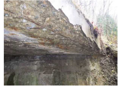
県道田山花輪線 中央橋 桁部の損傷による鉄筋露出
