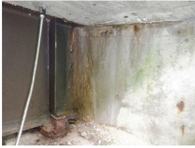
国道 103 号 生出5号橋 橋面からの漏水による支承発錆
