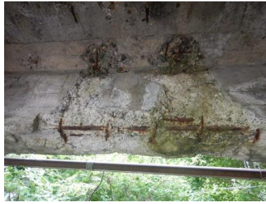
県道十二所花輪大湯線 新田橋 桁部の損傷による鉄筋露出
