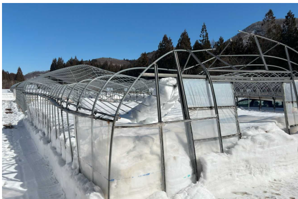
水稻育苗用パイプハウスの損壊（北秋田市）
