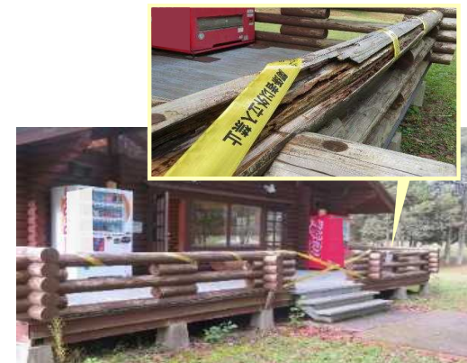
公園施設(デッキ手すりの老朽化)
