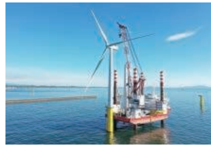
洋上風力発電設備の設置工事 提供：秋田洋上風力発電株式会社
