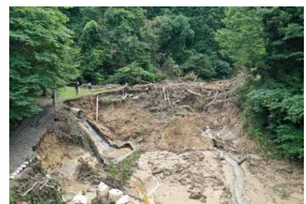
防災重点農業用ため池の決壊の状況
