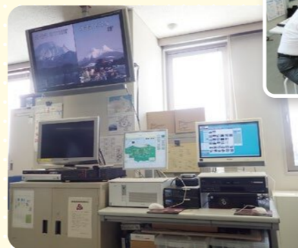
▲監視システムによるモニタリング
