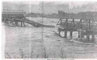
写真5 昭和47年7月洪水被害の様子
