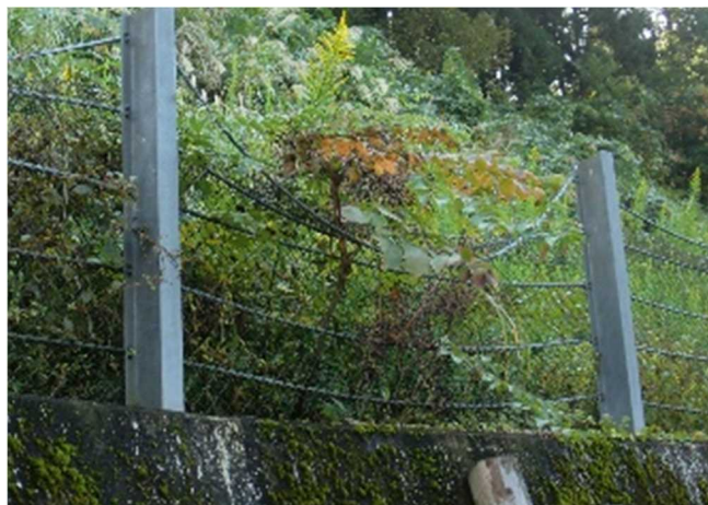
急傾斜地崩壊防止施設損傷例
