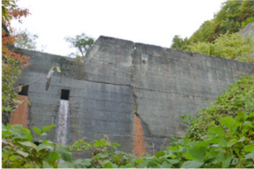
砂防堰堤損傷例
