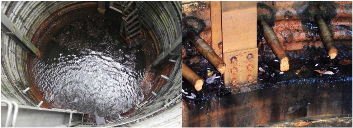
地すべり防止施設損傷例
