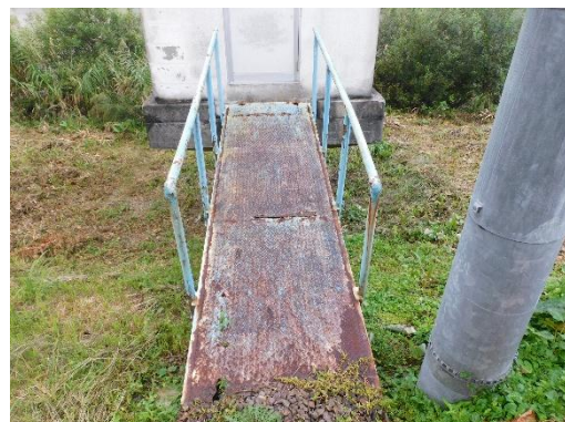
写 3-6-(4) 電気通信設備損傷例：柳町水位警報局 局舎前橋
