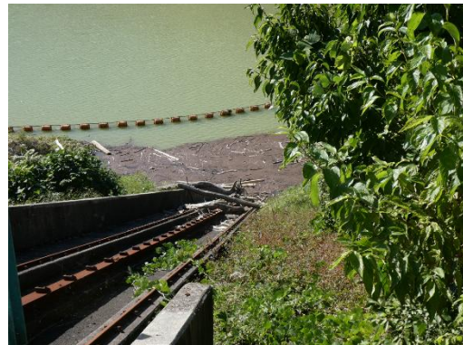
写 3-4-(4) 機械設備損傷例：流木処理設備
