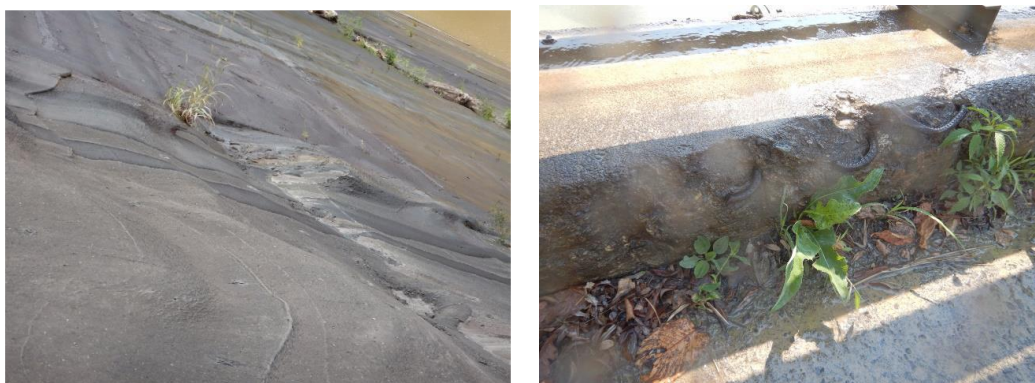
写 3-2-(1) 土木施設損傷例
