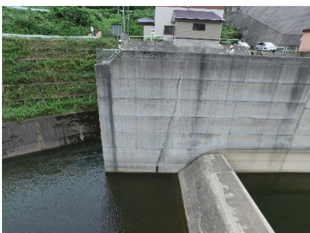
写 3-2-(2) 土木施設損傷例（評価：b 2）
