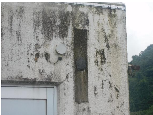
写 3-6-(1) 電気通信設備損傷例：2号クレストゲート室 入口照明
