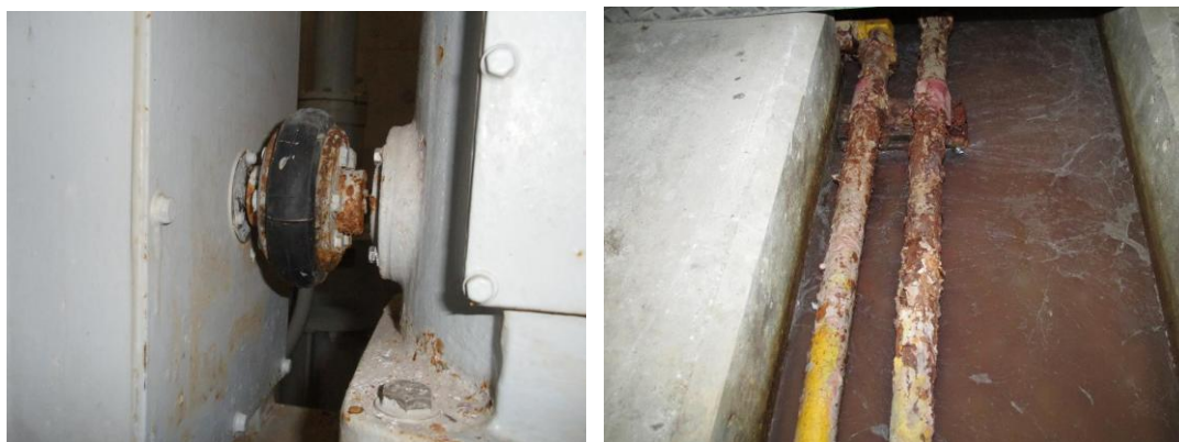
写 3-4-(1) 機械設備損傷例
