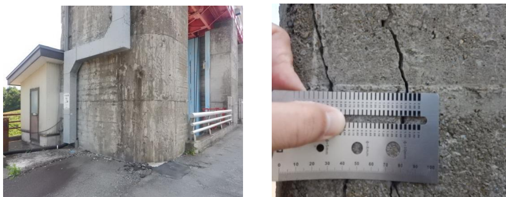
写 3-2-(2) 土木施設損傷例
