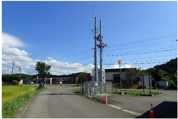
写 2-1-(3) 電気通信設備の例
