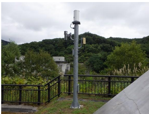
写 3-6-(1) 電気通信設備損傷例
