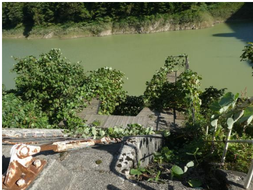
写 3-4-(3) 機械設備損傷例：係船設備
