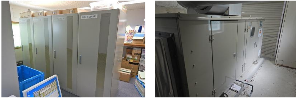
写 2-1-(3) 電気通信設備の例
