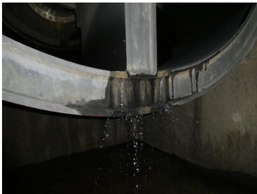
写 3-4-(1) 機械設備損傷例：常用洪水吐設備主ゲート
