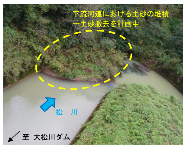
写 3-2-(3) 土木施設損傷例（評価：a 2）
