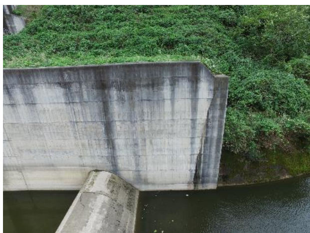
写 3-2-(1) 土木施設損傷例（評価：b 2）
