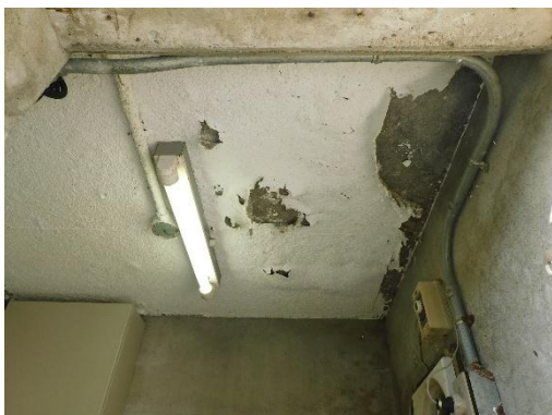
写 3-6-(3) 電気通信設備損傷例：根の台警報局 局舎内塗装
