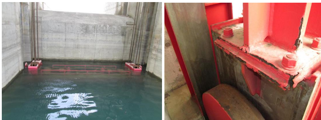
写 3-4-(2) 機械設備損傷例
