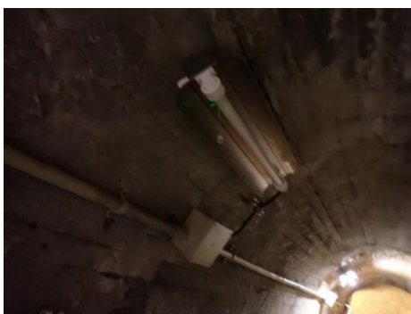
写 3-6-(1) 電気通信設備損傷例
