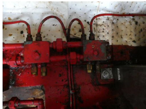
写 3-4-(2) 機械設備損傷例：常用洪水吐設備予備ゲート
