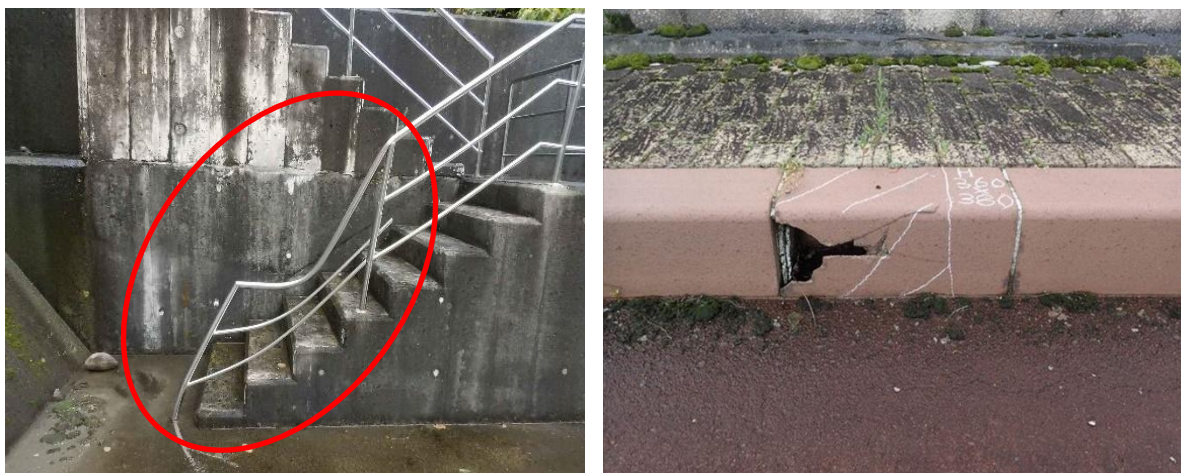
写 3-2-(2) 土木施設損傷例
