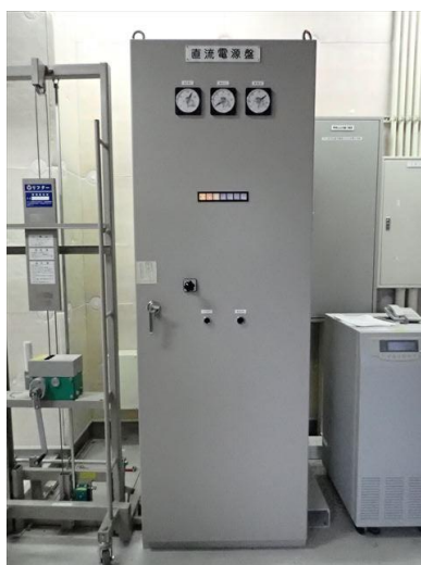
写 3-6-(1) 電気通信設備損傷例（直流電源設備：大松川ダム）
