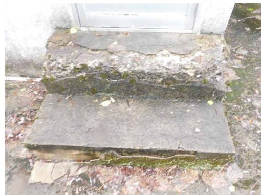
写 3-6-(2) 電気通信設備損傷例：砂子渚警報局 局舎階段
