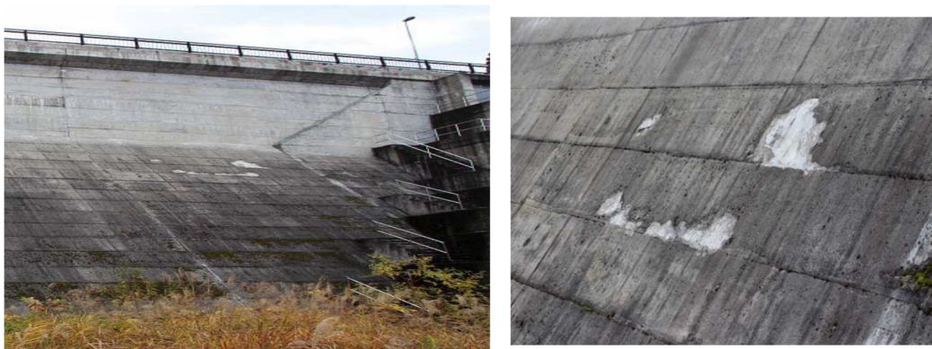
写 3-2-(1) 土木施設損傷例
