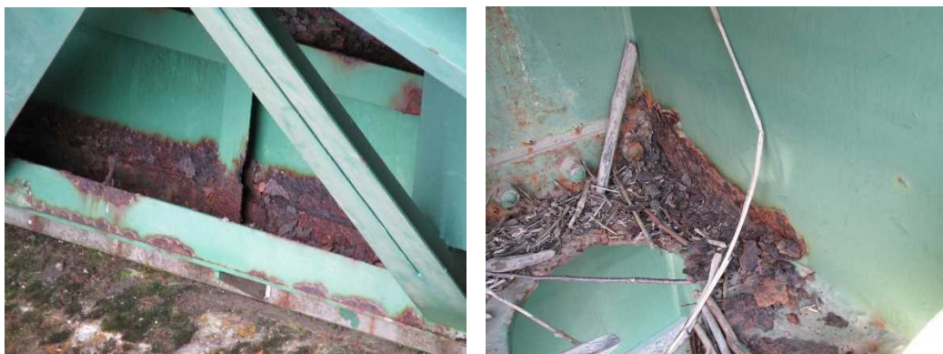
写 3-4-(1) 機械設備損傷例
