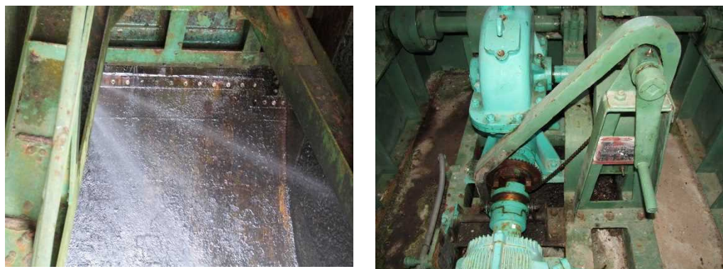
写 3-4-(2) 機械設備損傷例
