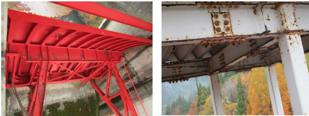
写 3-4-(1) 機械設備損傷例
