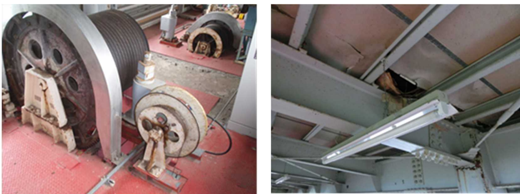
写 3-4-(2) 機械設備損傷例
