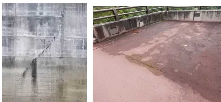
写 3-2-(2) 土木施設損傷例
