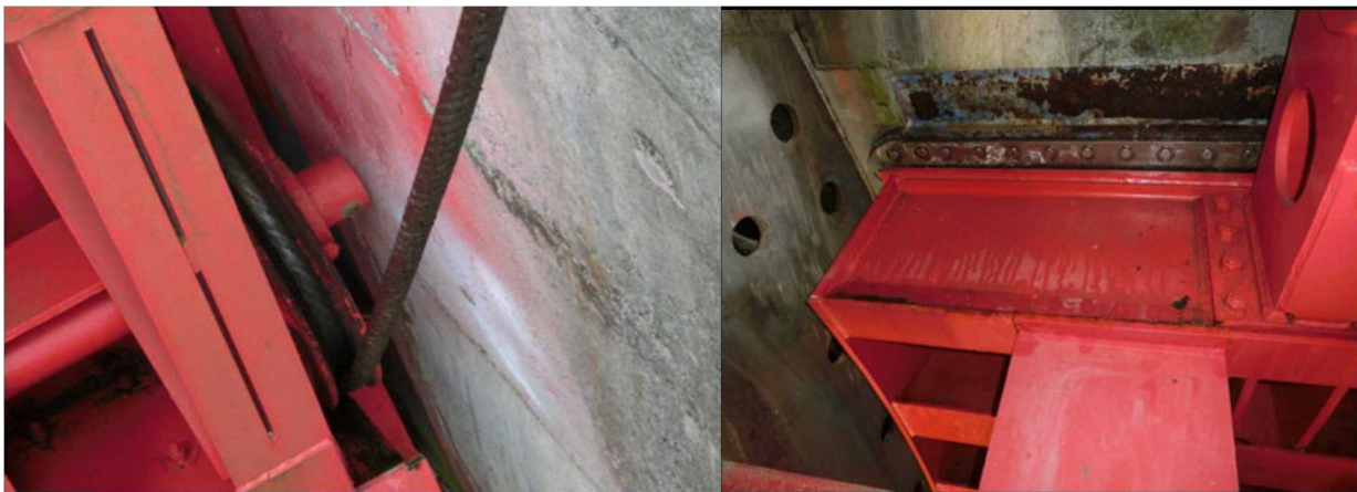
写 3-4-(1) 機械設備損傷例
