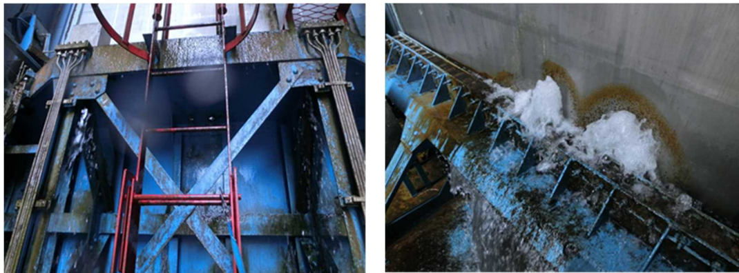
写 3-4-(1) 機械設備損傷例
