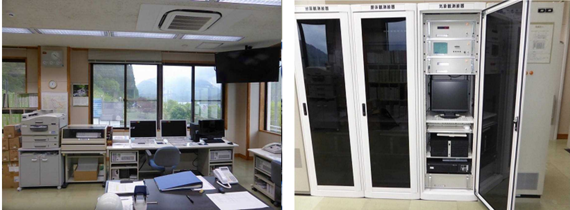
写 2-1-(3) 電気通信設備の例
