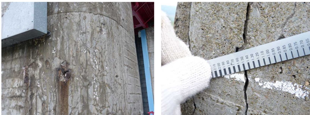
写 3-2-(2) 土木施設損傷例
