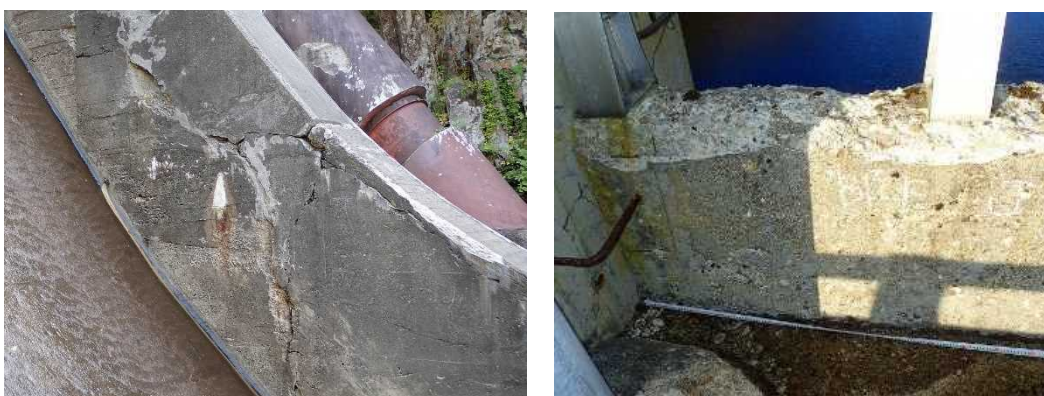
写 3-2-(2) 土木施設損傷例
