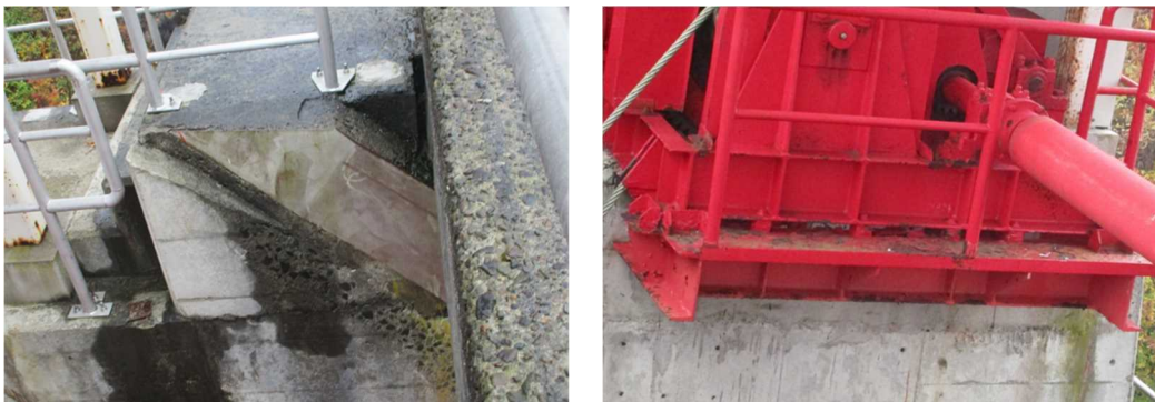
写 3-4-(2) 機械設備損傷例
