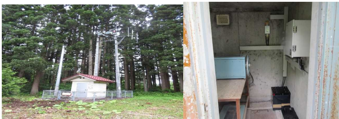
写 3-6-(2) 電気通信設備損傷例
