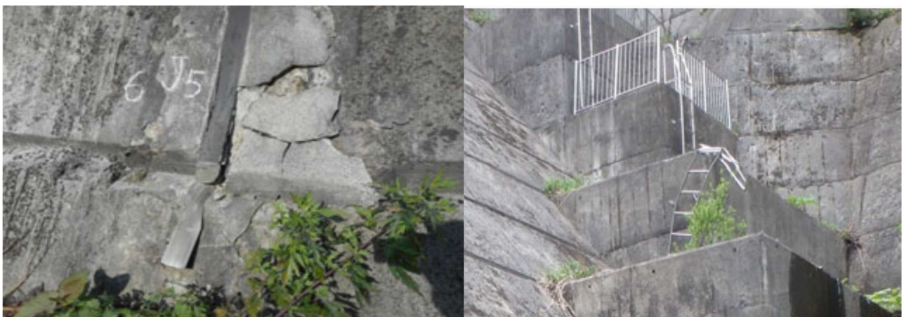
写 3-2-(2) 土木施設損傷例
