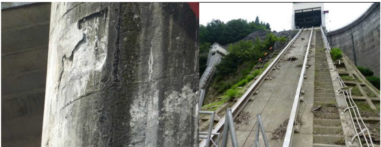
写 3-2-(1) 土木施設損傷例
