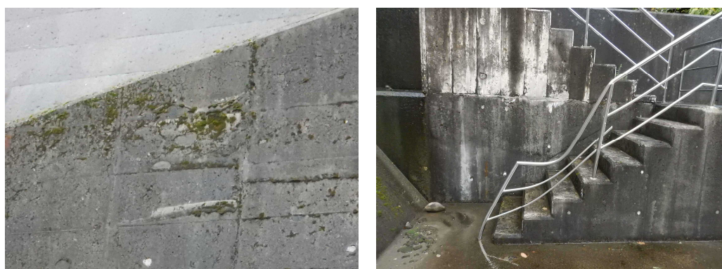
写 3-2-(1) 土木施設損傷例
