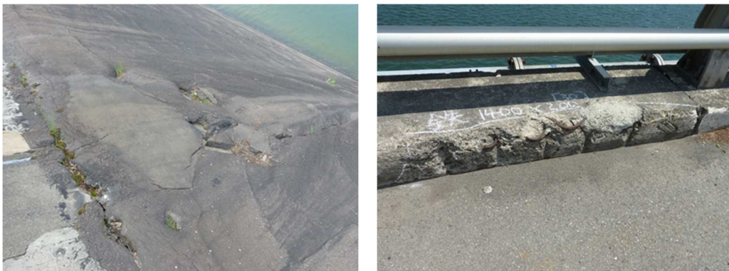
写 3-2-(1) 土木施設損傷例
