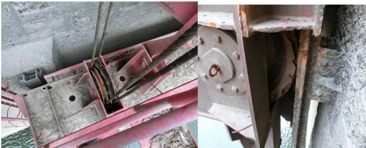
写 3-4-(2) 機械設備損傷例
