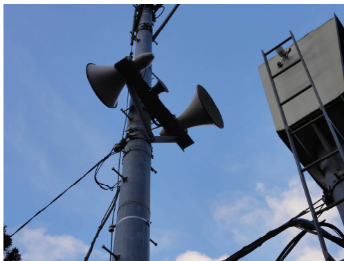
写 3-6-(2) 電気通信設備損傷例
