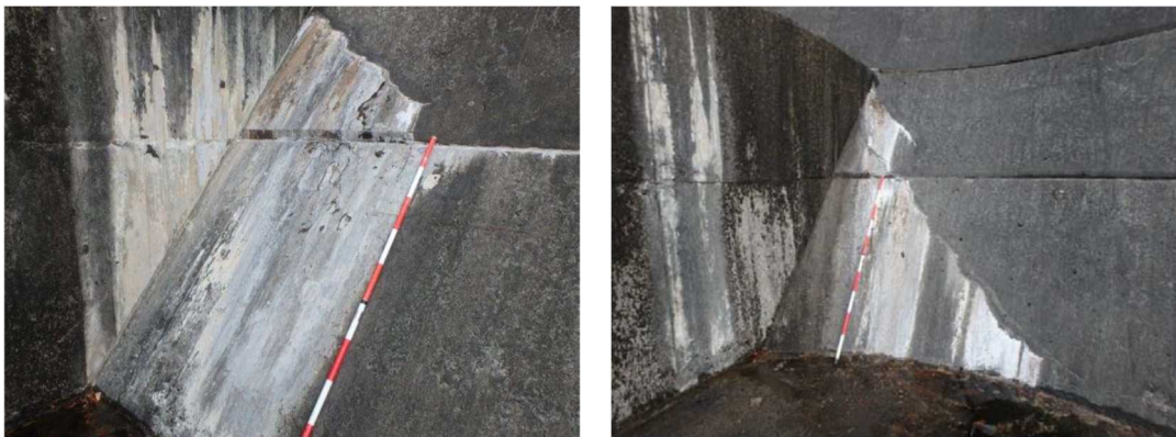
写 3-2-(1) 土木施設損傷例
