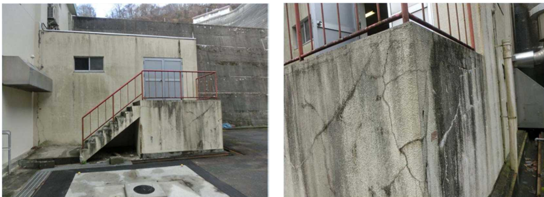
写 3-2-(2) 土木施設損傷例
