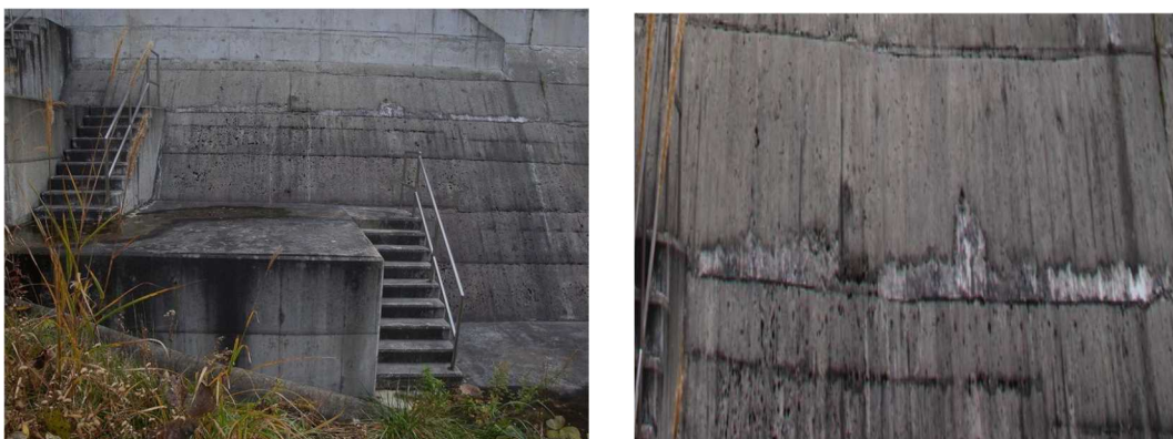
写 3-2-(2) 土木施設損傷例
