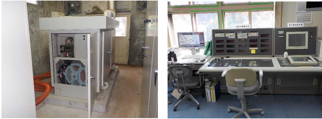
写 2-1-(3)電気通信設備の例
