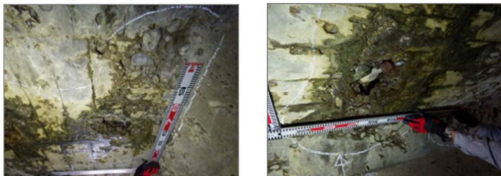
図.6 函体・頂版損傷例
