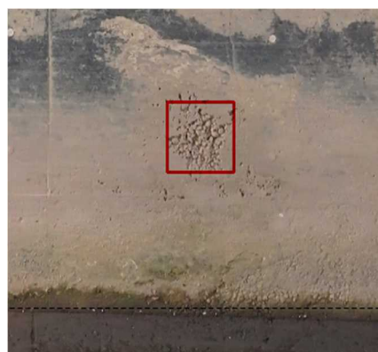
図.8 中央函体 側壁 豆板
