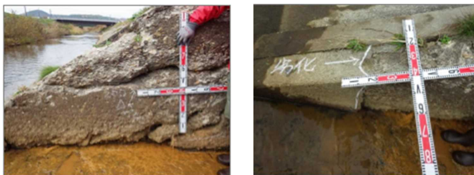
図 5. 翼壁・川表損傷例
