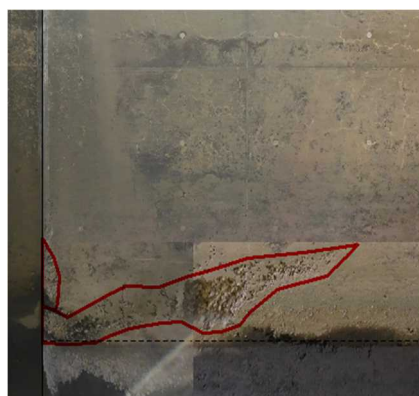
図.7 右側函体 側壁 剥落・豆板
