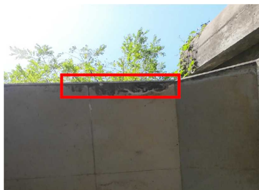
図.6 中央函体 頂版 鉄筋露出
