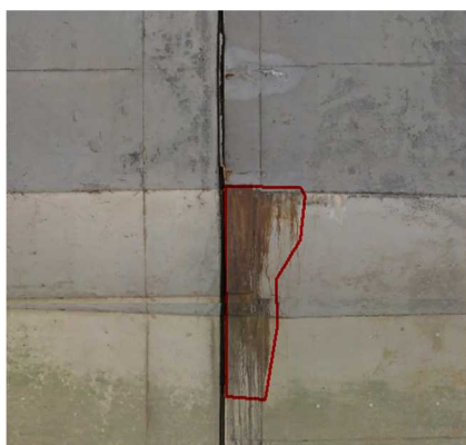
図.5 左側函体 頂版 錆汁
