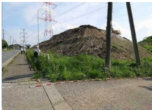
道路沿いの平地等に看板や標識の設置もなく造成された盛土等(不法盛土)
