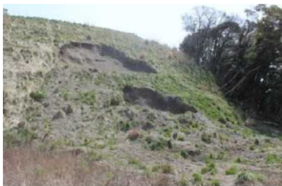
盛土のり面に部分的な崩壊や亀裂が生じ、崩壊し始めている盛土等(危険盛土)
