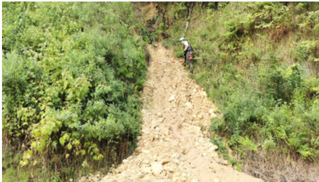
法面崩落状況
