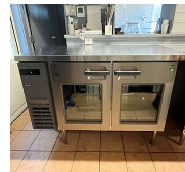
冷凍冷蔵設備
