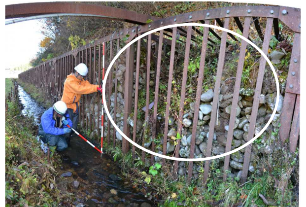
腐食により詰石が崩落した鋼製護岸（羽後町）
