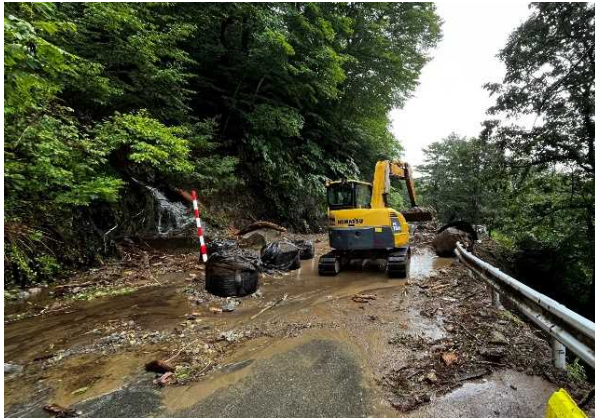
豪雨災害により山地から県道に大量の土砂が流出（仙北市）
