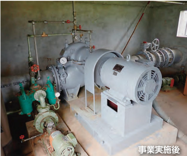
平城揚水機（湯沢市）
