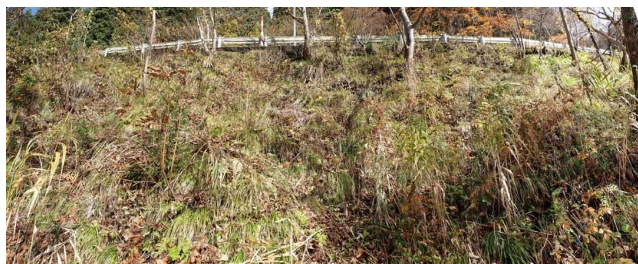
道路下の表層崩壊状況
