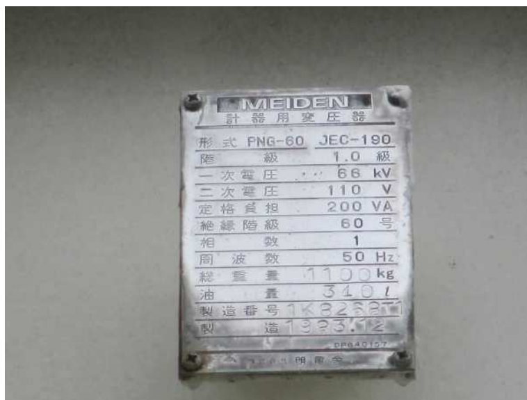
①計器用変圧器銘板
