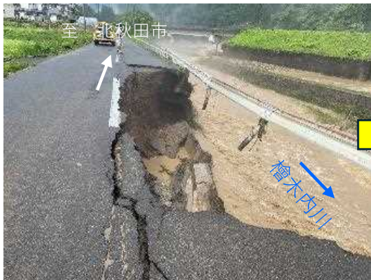
8月20日 道路損壊
