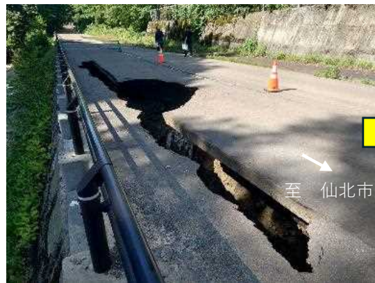
8月21日 道路損壊の状況
