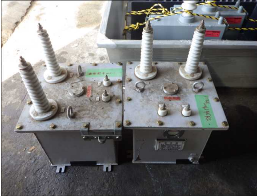
鎧畑発電所修理工場保管品
