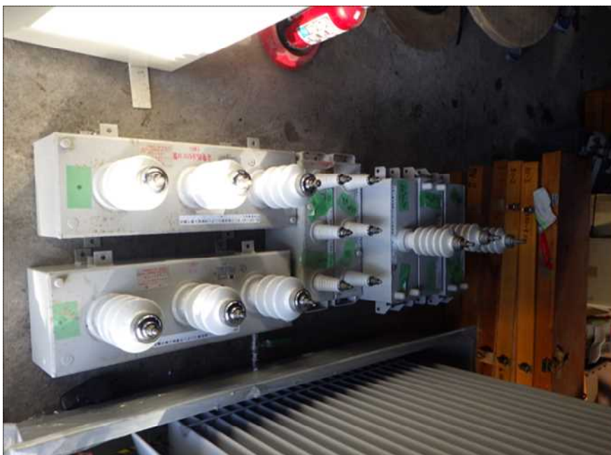
鎧畑発電所修理工場保管
