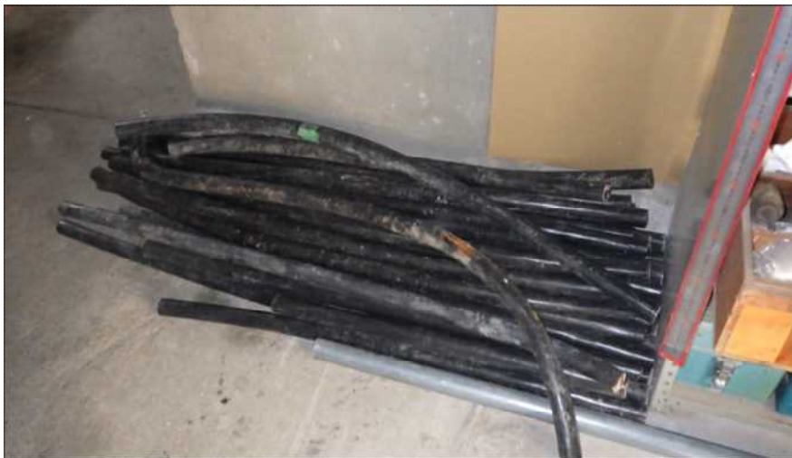
鎧畑発電所修理工場保管
