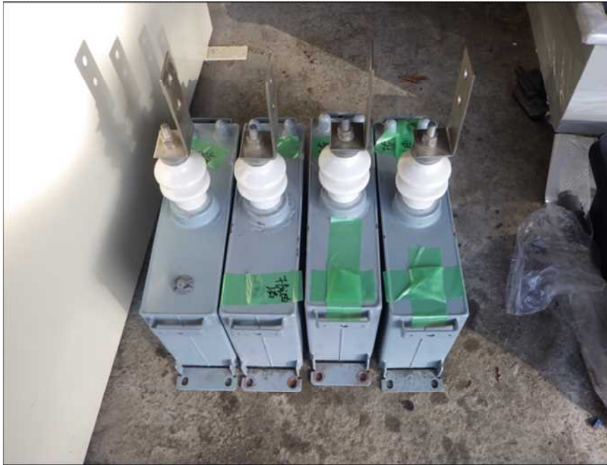
鎧畑発電所修理工場保管品
