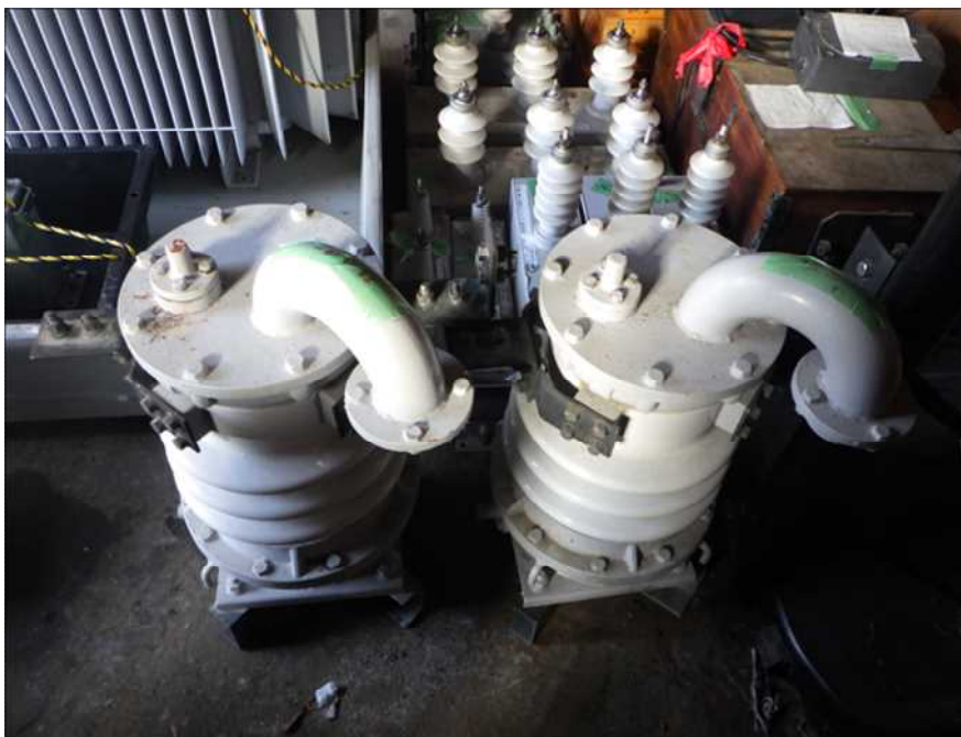
鎧畑発電所修理工場保管品
