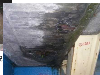
▼鉄筋が露出した床版
