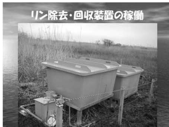
図 5 リン湧出水を導入するリン除去・回収装置
