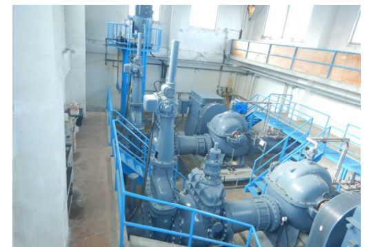
〔大川西根揚水機場（大仙市）〕
