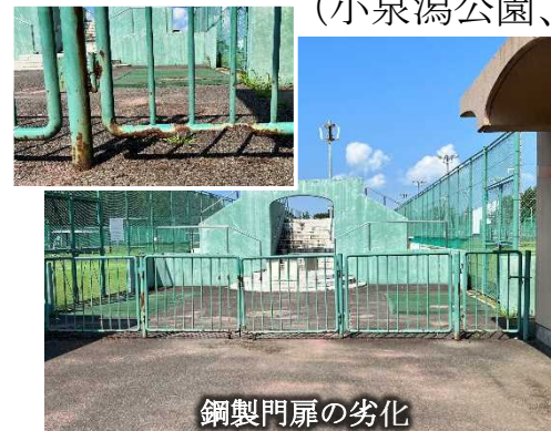
鋼製門扉の劣化 中央公園（秋田市） 【テニスコート門扉更新】
