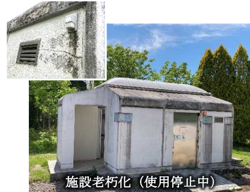
施設老朽化（使用停止中） 北欧の杜公園（北秋田市） 【トイレ更新】
