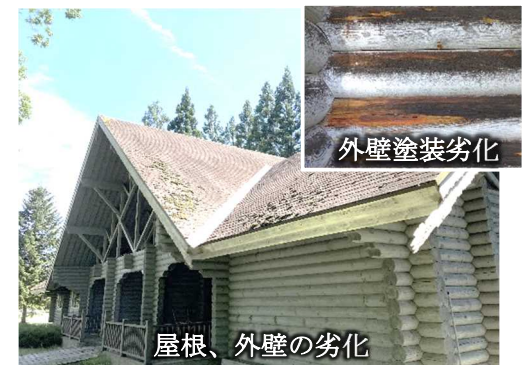
屋根、外壁の劣化 北欧の杜公園（北秋田市） 【中央休憩所修繕】
