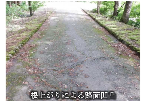
根上がりによる路面凹凸 小泉潟公園（秋田市） 【サイクリングロード舗装補修】
