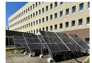
太陽光発電設備(※1)
