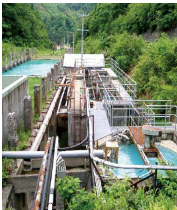
吉乃鉱山（横手市）坑廃水処理施設
