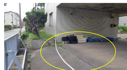
職員宿舎 南側 地盤沈下によるひび割れ
