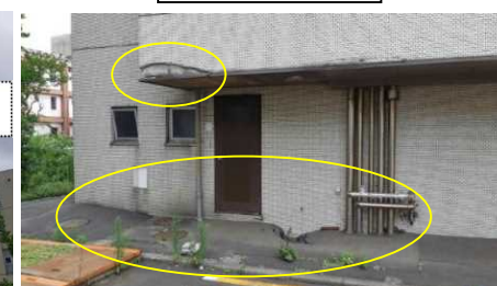
職員宿舎 北側 外壁落下、地盤沈下による歪み
