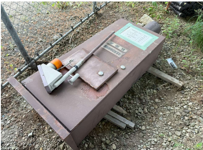
NO.9 消雪用自動制御盤
