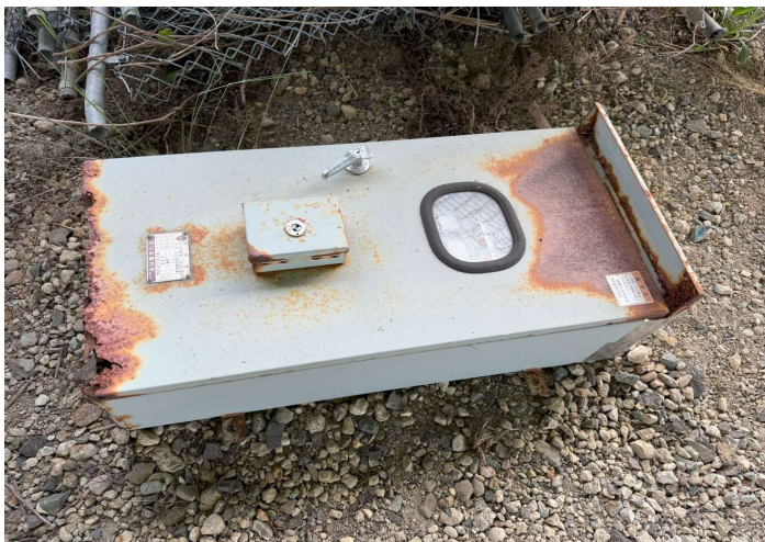
NO.17 散水設備制御盤
