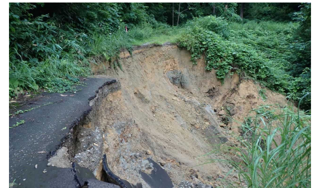
〔林道崩落（湯沢市山院線）〕
