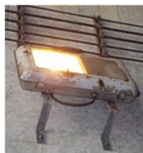
鳥田目トンネル 照明灯
