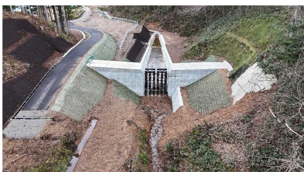
浅田沢1 砂防えん堤 R6. 3月時点
