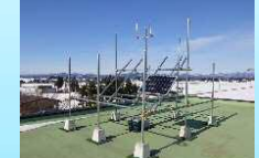
LPWA基地局(仮設)
