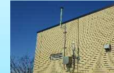
RTK基地局アンテナ
