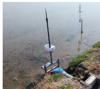
田んぼに設置した自動給水ゲート(左)と水田センサー(右)
