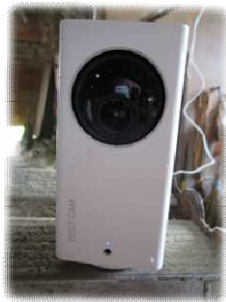
牛舎に設置したカメラ
