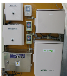
統合環境制御盤
