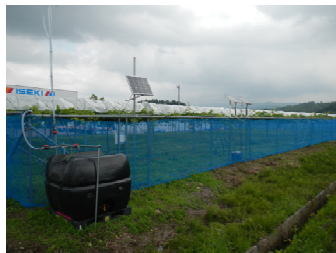
自動灌水用の太陽電池パネルと貯水タンク
