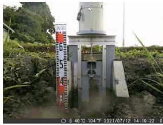
降雨時の貯水状況(中干し時期)
