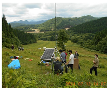
基地局の設置
