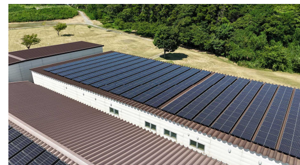
事業活用による太陽光パネル設置事例
