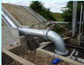
水害対策のため設置した内水排除ポンプ
