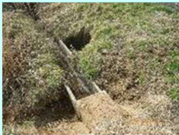
不具合箇所 (水路)
