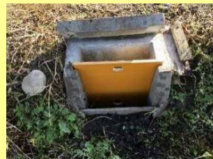
調整板を設置した排水樹
