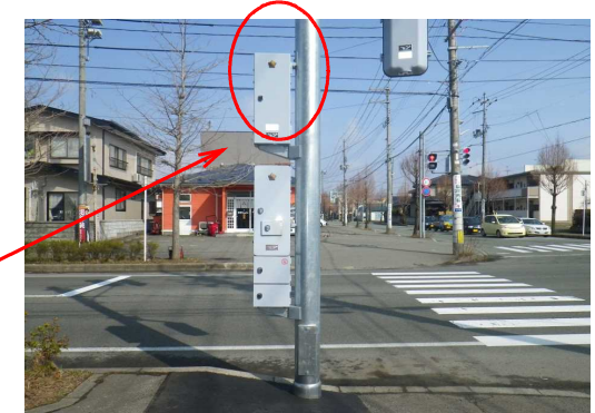
電池式信号機電源付加装置
